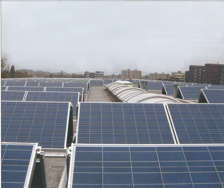
Vorreiter im Klimaschutz: Das Unternehmen Ruksaldruck produziert Strom mit einer Photovoltaik auf dem Firmendach.
